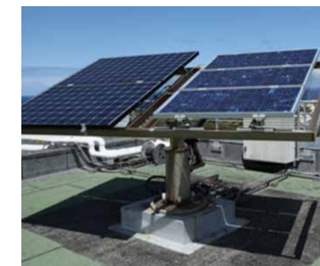
Figure 21 – Banc d'essais de différents panneaux PV
